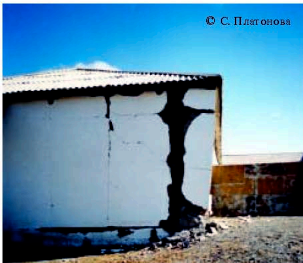
Характер разрушения в школе пос. Бельтир после землетрясения
